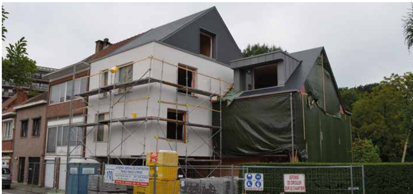
Rue des Pêcheries, 63 : construction de deux maisons passives destinées à des ménages à revenus moyens. Visserijstraat, 63: bouw van twee passiefhuizen voor gezinnen met middelgrote inkomens.
