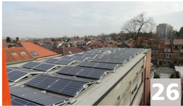
Des panneaux photovoltaïques à La Futaie Fotovoltaïsche panelen in La Futaie
